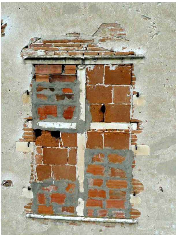
Figure 57 : Troisième croisée en partant de l'ouest (FEN 2505). On distingue sous l'enduit les traces d'un arc de décharge, couvrement d'une ancienne fenêtre jumelée.
