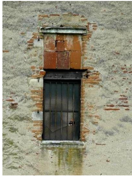
Fig. 48 : Demi-croisée détruite (FEN 2805)
