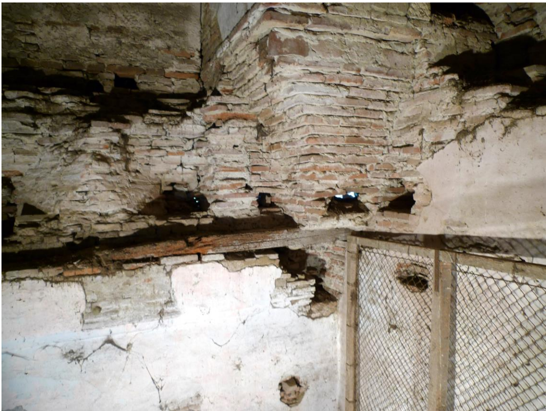
Figure 91 : Partie inférieure de l'échauguette disparue à l'angle sud-ouest (TUR 43), visible depuis l'intérieur.
