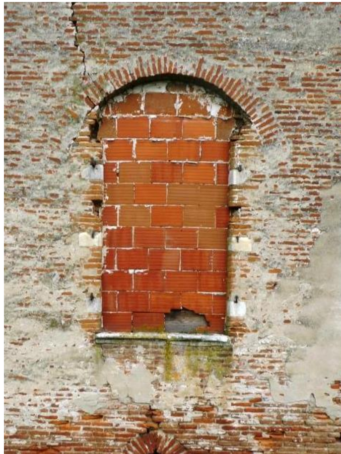
Figure 49 : Couvrement d'une fenêtre jumelée remplacée par une croisée, détruite et murée (FEN 2705) : on remarque encore les encoches pour les croisillons et le linteau.
