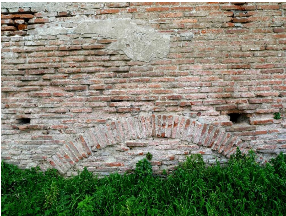
Figure 63 : Arc de décharge (?) au niveau du sol à gauche/sud.
