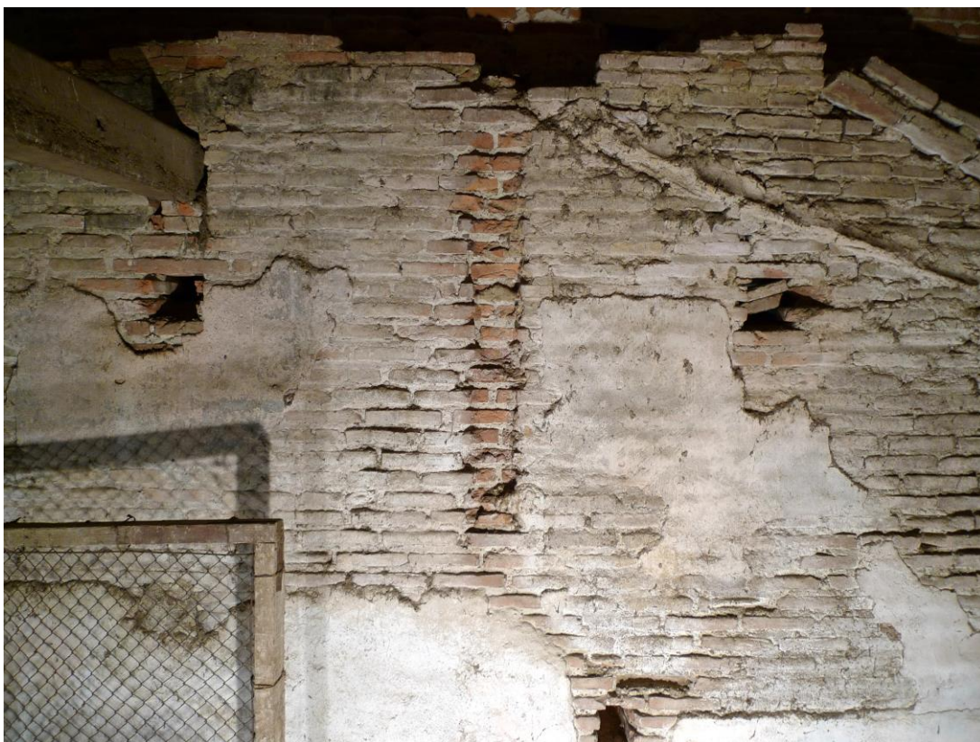
Figure 89 : Trace d'arrachement sur le mur ouest (MUR 2602) correspondant peut-être à l'emplacement d'une ancienne cloison.
