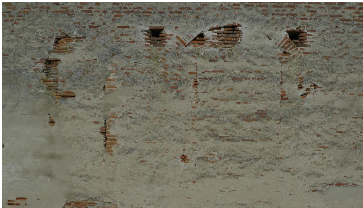
Figure 50 : Côté sud de la façade : traces de reprises à gauche/nord et couvrement d'une fenêtre jumelée reprise et bouchée à droite/sud.
